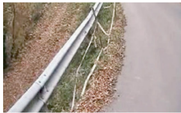
La strada dissestata a Gaiato di Pavullo
